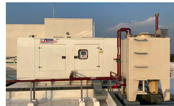
Thiết kế, cung cấp và lắp đặt hệ thống máy phát điện
